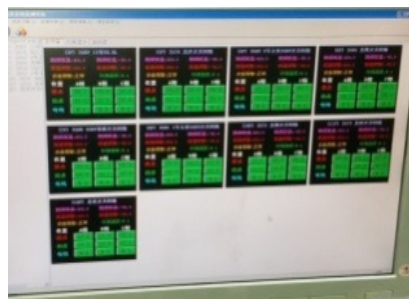
变电站光纤温度监测软件
